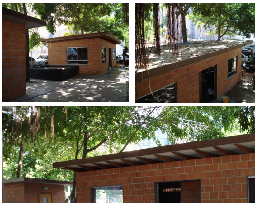
Figuras: 12, 13 e 14. Detalhes de estrutura e cobertura vegetal ainda em plantio em edificação com materiais e técnica simplificada de confecção.
