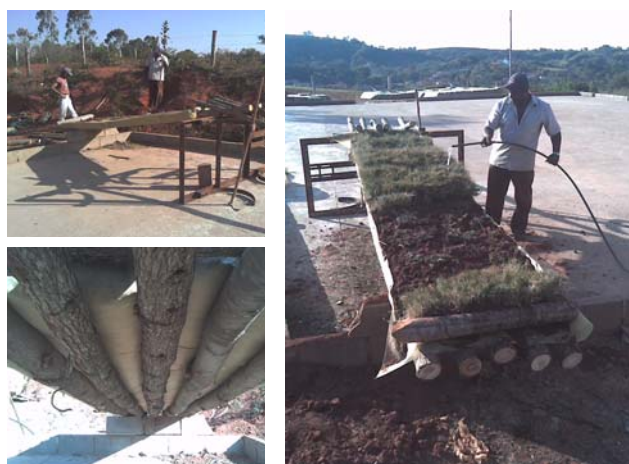
Figs 9,10 e 11. Sistema construído com caibros roliços e lona com canaleta de drenagem
