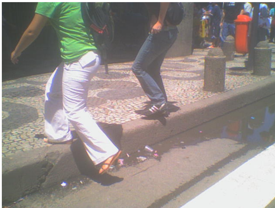
Figura 3: Acessibilidade – Calçada com altura de meio fio que leva a pessoa a realizar maior esforço para subir o degrau. Alguns trechos possuem degraus com aproximadamente 25 cm. Os portadores de necessidades especiais e pessoas com mobilidade reduzida são os mais prejudicados no uso da travessia.
